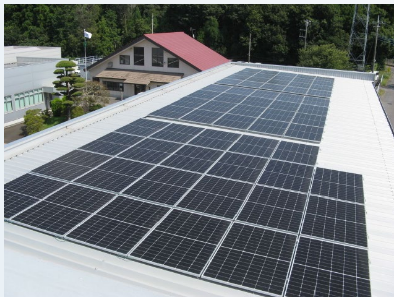
[茨城工場(パネル設置箇所の一部)]
